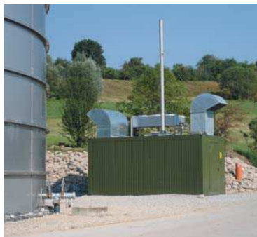
Zespół, silnik gazowy oraz generator prądu zabudowanew kontenerze.
